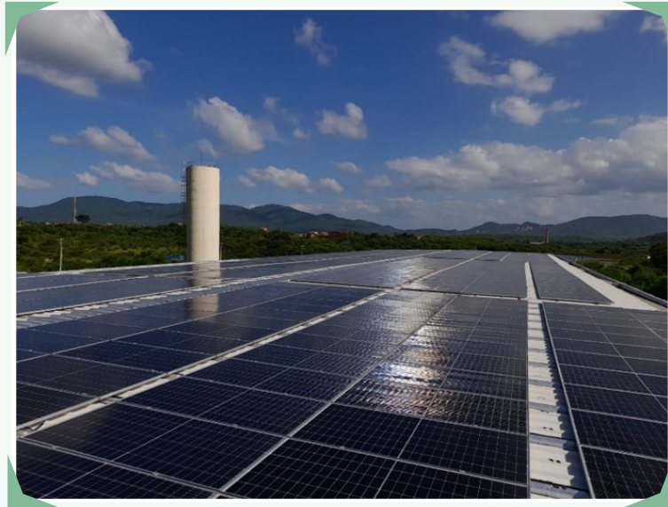
Figura 5: Vista de parte das placas fotovoltaicas da expansão do sistema fotovoltaico, no restaurante universitário do campus das Auroras
