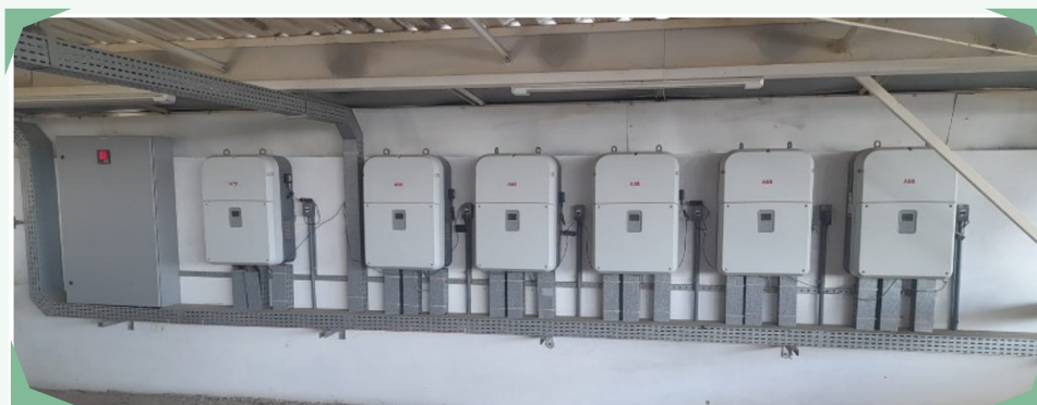
Figura 3: Inversores referentes ao sistema fotovoltaico inicial, no bloco didático do campus das Auras
