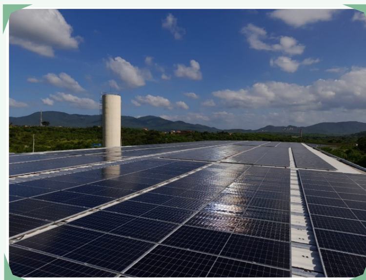
Figura 5: Vista de parte das placas fotovoltaicas da expansão do sistema fotovoltaico, no restaurante universitário do campus das Auras
