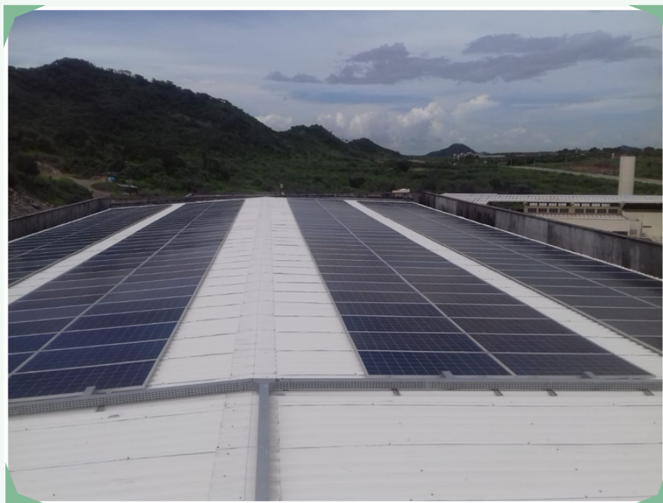
Figura 2: Vista de parte das placas fotovoltaicas do sistema no bloco didático, campus das Auras
