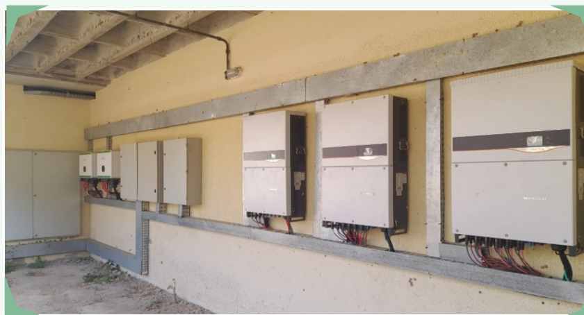
Figura 6: Inversores referentes a expansão do sistema fotovoltaico, no restaurante universitário do campus das Auras
