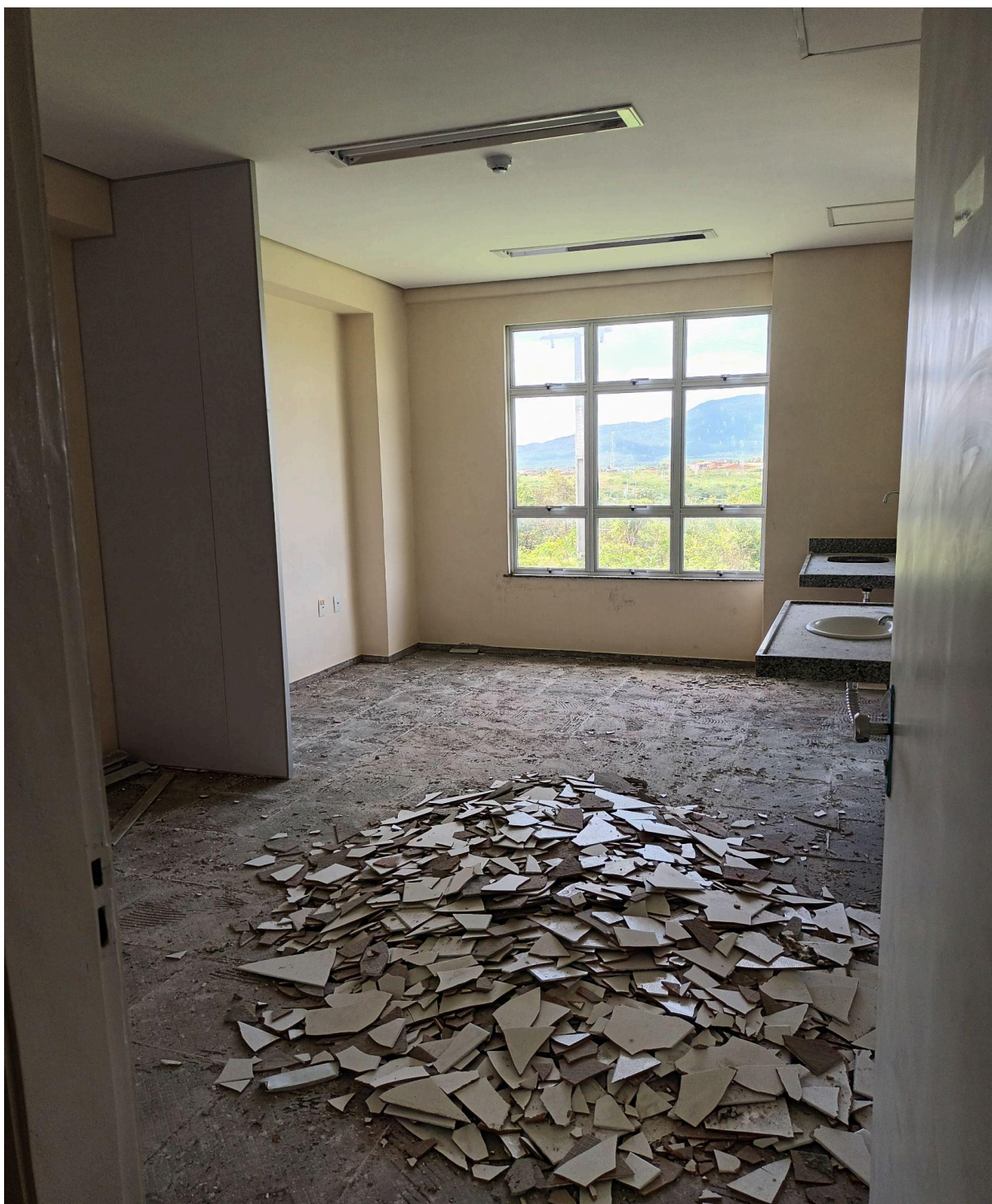
Figura 2: Placas de piso cerâmico dos dormitórios do bloco B1 e B2 descolando.
