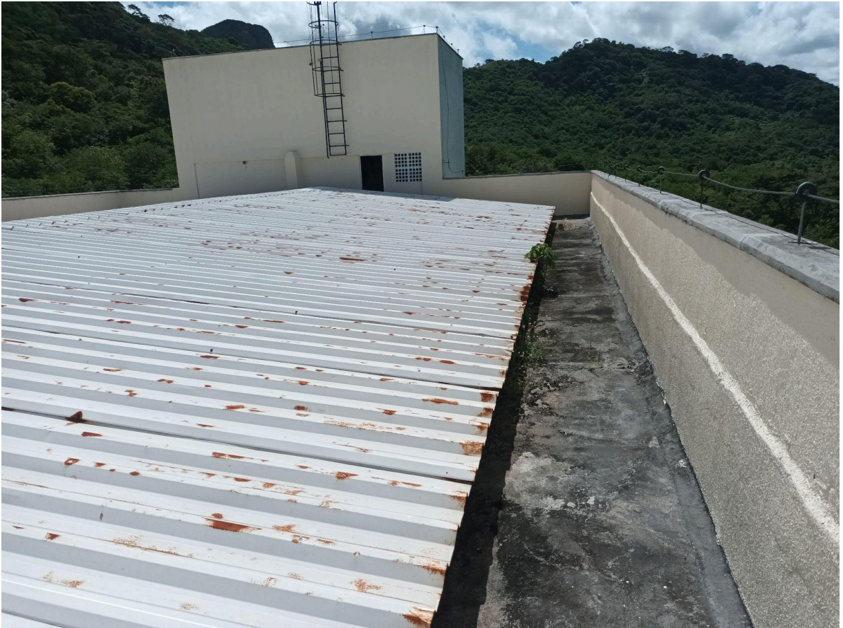
Figura 5: Calhas de escoamento para as águas pluviais do bloco B1 e C1 ocasionando infiltrações, necessitam de impermeabilização.
