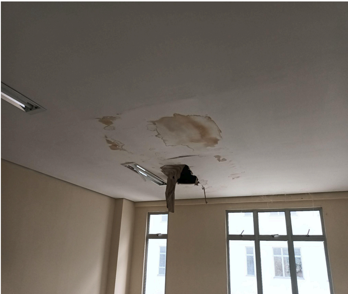
Figura 3 -Forro de gesso acartonado dos hall dos blocos B1 e C1 necessitam de recuperação e massa corrida e pinturas.
