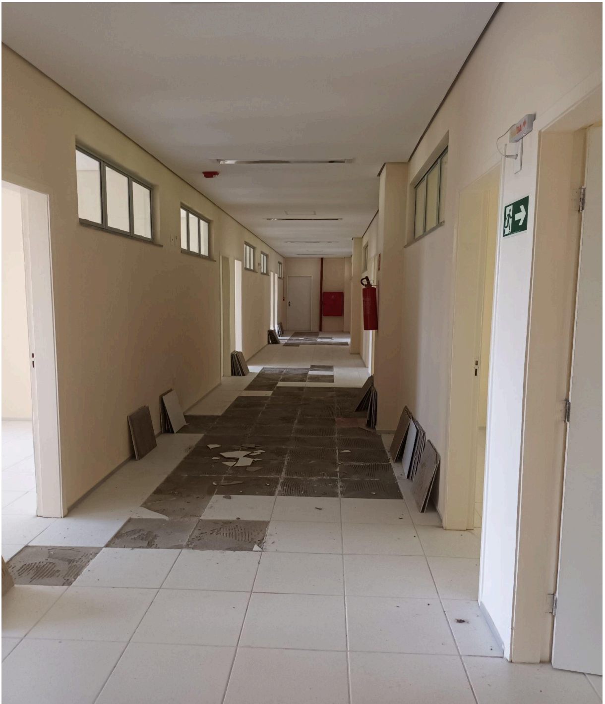
Figura 1 – Placas de piso cerâmico dos corredores do bloco B1 e C1 descolando.
