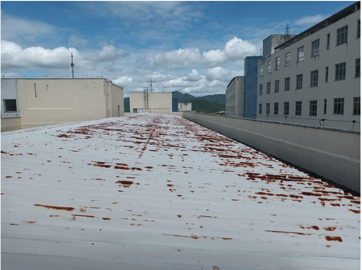
Figura 4:Telhado estrutural da cobertura do bloco B1 e C1 necessita de recuperação.
